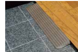
玄関(あがりかまち)の段差
