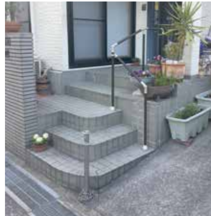
玄関ポーチの手すり 玄関ポーチ階段の昇り降りとポーチ内での移動をサポートします。
